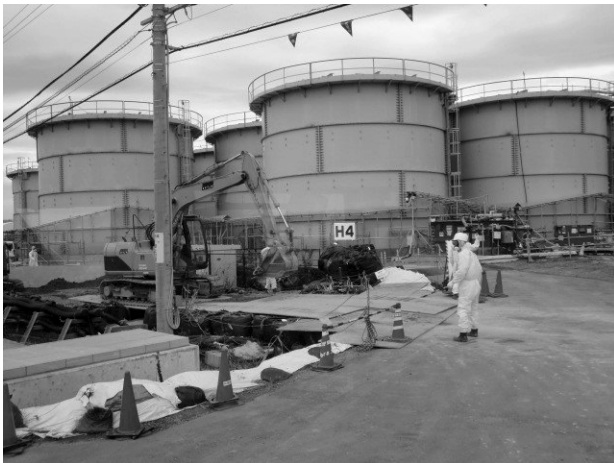
写真7 昨年度に漏洩を起こした高濃度汚染水の貯水タンクと作業中の作業員これらのタンクは現在使用されておらず、全て一体鋳造型のタンクに置き換えられている。
