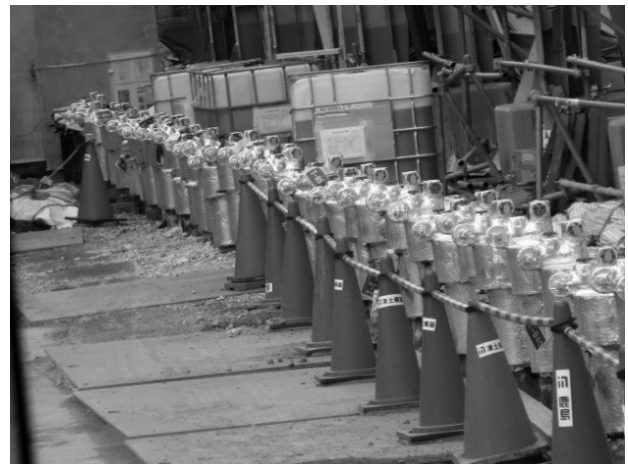
写真6 4号機の近くに突き刺すように埋設された冷却 用パイプ群 1～4号機の周囲に総延長1500mにわたり地下 水を遮水する凍土壁を形成させる予定だという。
