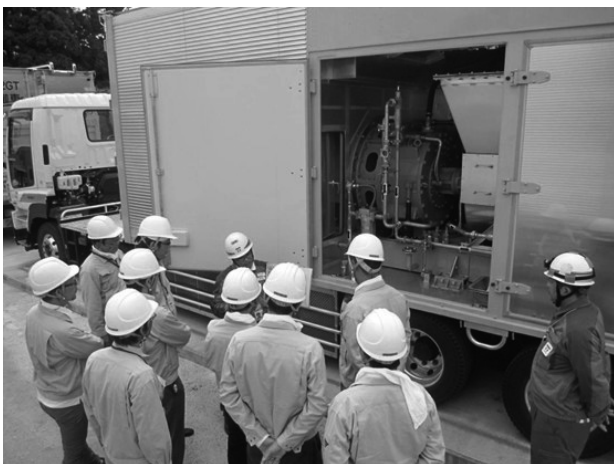
写真3 発電所敷地内の高台に設置された緊急時発電機（大型トレーラーの荷台に巨大なガスタービン式発電機を搭載）
