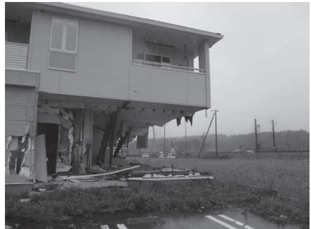
図6：旧富岡駅西側のアパート。今も津波の跡が見える。後方は復旧工事中の常磐線の線路（平成28年9月撮影）。
